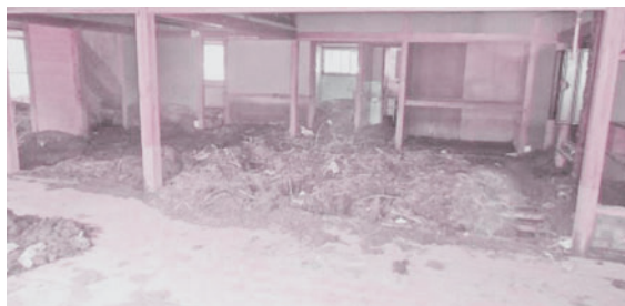
浸水被害を受けた家屋
